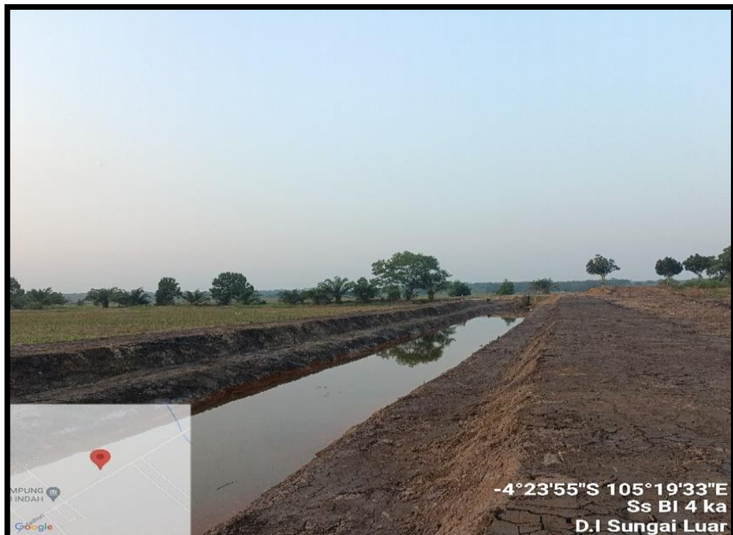
Pembangunan jaringan irigasi daerah irigasi rawa sungai luar Kampung sungai luar Kecamatan Menggala Timur
