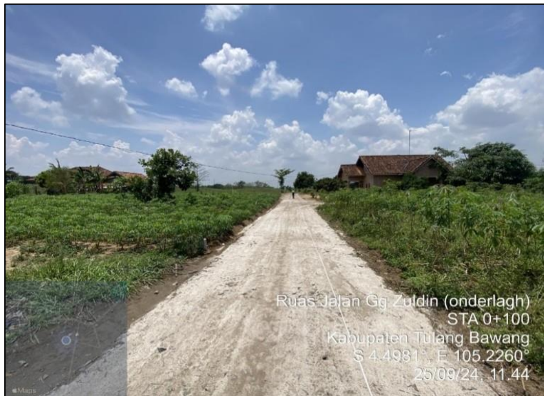
Pemeliharaan Berkala Peningkatan Jalan Cemara Komplek Pemda Gg. Zuldin Kelurahan Menggala Selatan
