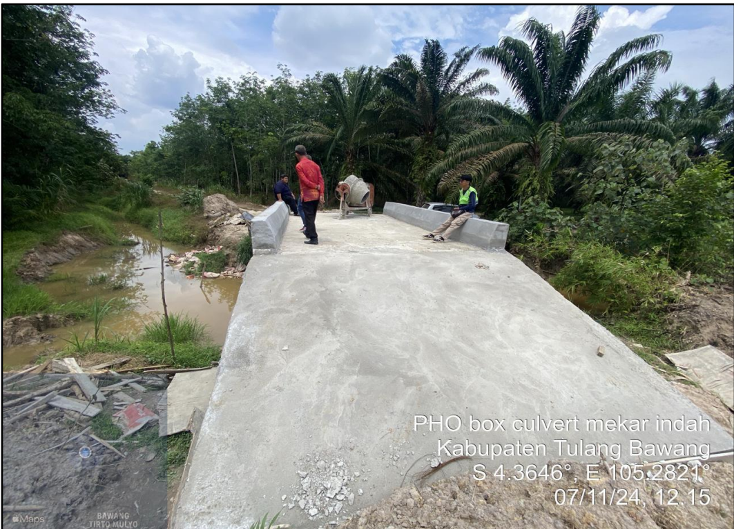
Pembangunan Jalan Box Culvert Kampung Mekar Indah Jaya Rt. 004 Rk. C04 Kec. Banjar Baru
